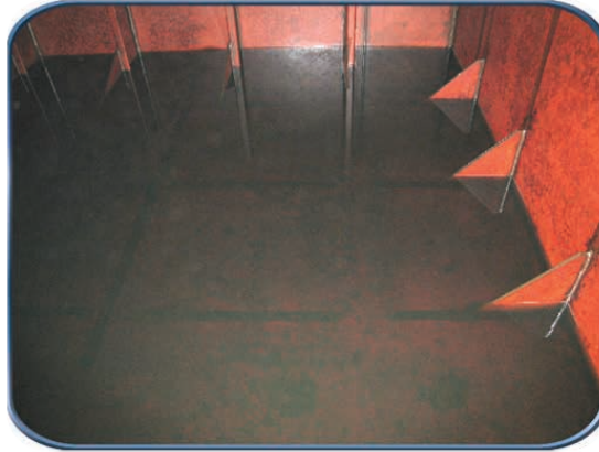
Cuve de sédimentation
